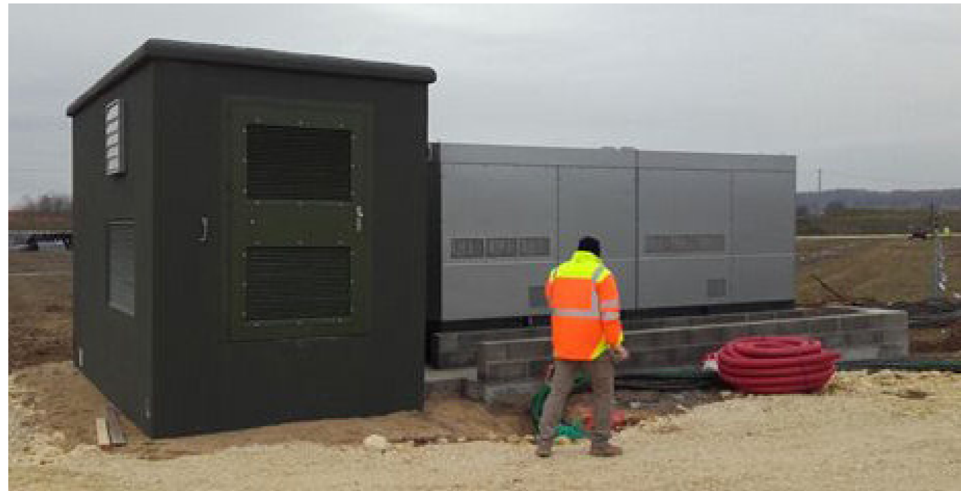
Le poste de livraison est peint d'une teinte vert moyen de type RAL6003 qui assurera une certaine cohérence visuelle avec les pentes enherbées du bassin sur lesquelles il se détache ainsi de façon plus mesurée
