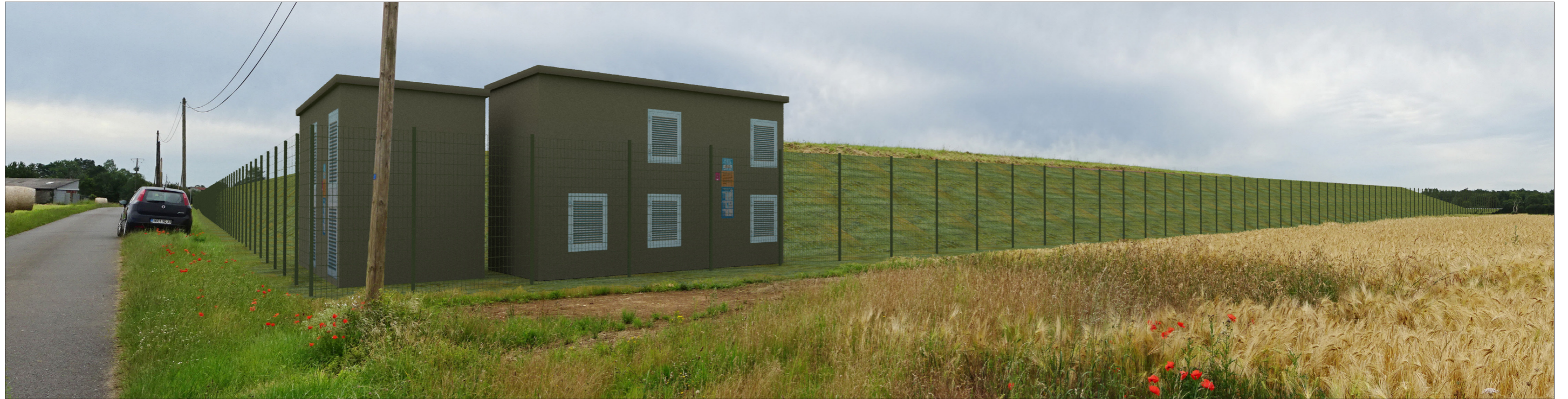
Réalisée depuis la route reliant la Chapelle Bâton et le hameau les Vaugelais, cette vue permet d'illustrer la centrale au niveau de l'angle ouest. On y voit les deux postes électriques et la clôture alors que la partie flottante est masquée par les berges. L'effet visuel de la centrale est ici limité
